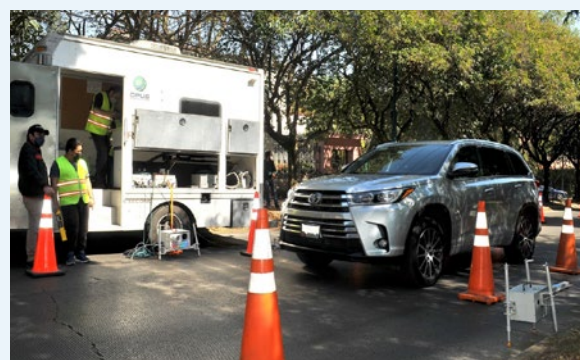
(Incluir si hay espacio) Instalación de dispositivo de teledetección en Blvd. de los Virreyes en la Ciudad de México.
